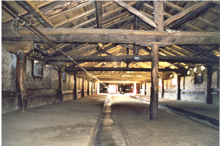
Vista interna dello stallone di Malga Boch: si noti l'integrazione degli impianti a vista ed il puntone che sorregge la capriata più sollecitata (quelle in testa).
