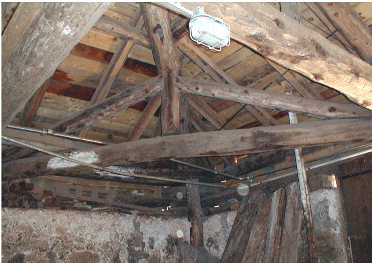
Particolare della capriata d'angolo disposta (in pianta) a 45° a sostegno della conversa.
